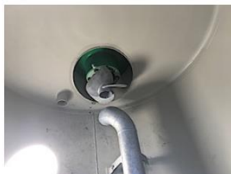
Miešacia vrtuľa je umiestnená v dolnej časti nádrže. Na obrázku je i časť systému vyprázdňovania v kopci.
